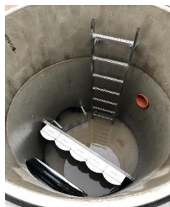
Filterbrunn i armerad betong
